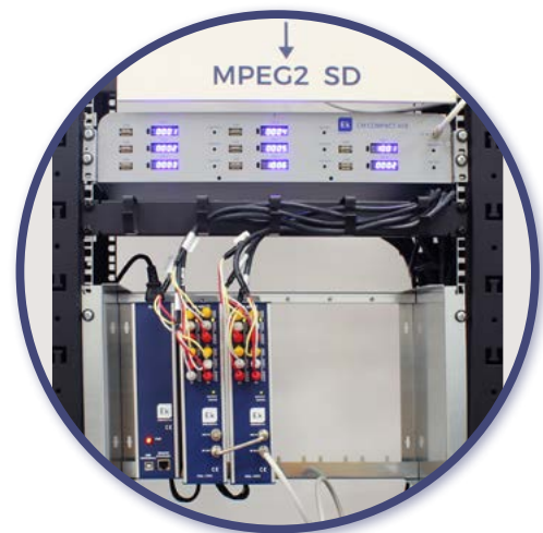
Ejemplo de KIT CM COMPACT AV8 instalado en un armario rack
