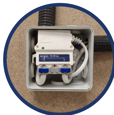
Instalação em caixa de 80 x 80mm
