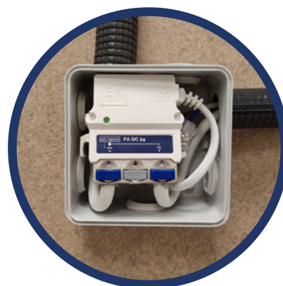
Installazione in scatola di derivazione da 80 x 80mm
